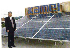
屋上には世界中で活躍するサン テックパワー社の太陽光発電モ ジュールを設置。
